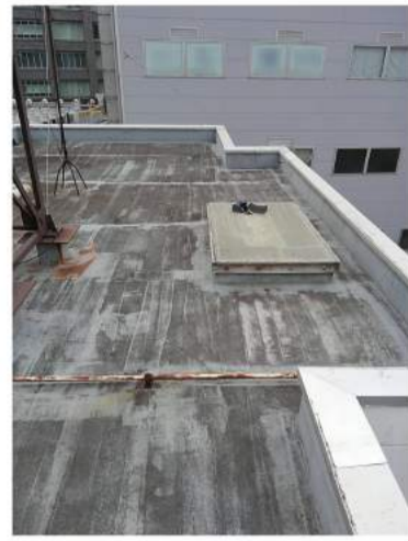
笠木（手すり部分）にも劣化によるひび割れが。
