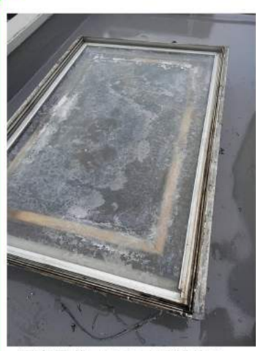
天窓用ガラスのフチ部分の隙間から雨漏りの疑いも。
